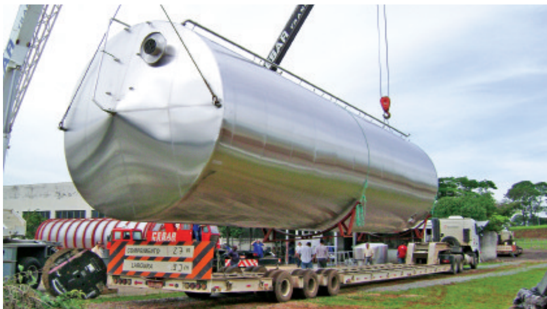
Silos isotérmicos desenvolvidos pela Dec Brasil são exemplo de investimento em tecnologia no setor metalúrgico
